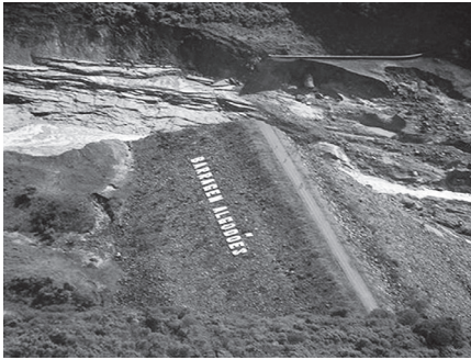
(a) Barragem após o episódio
