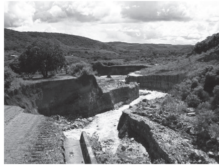
(b) Barragem após o episódio
