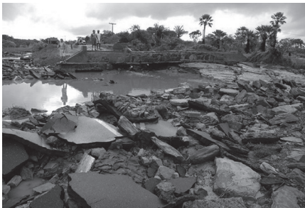
(c) Rodovia destruída
